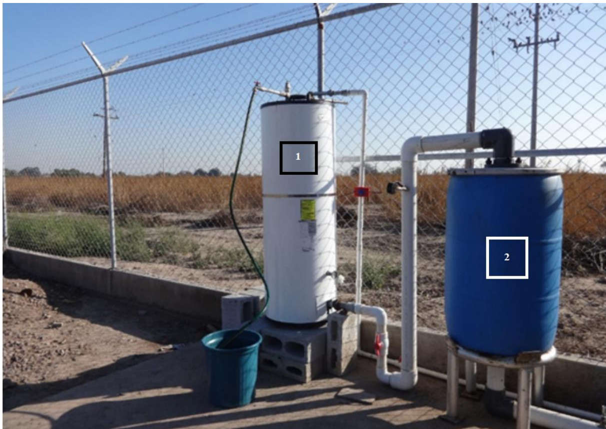
Figura 3. Banco de ensayo con calentador CALOREX G-60 (1) y filtro H_2S (2).
